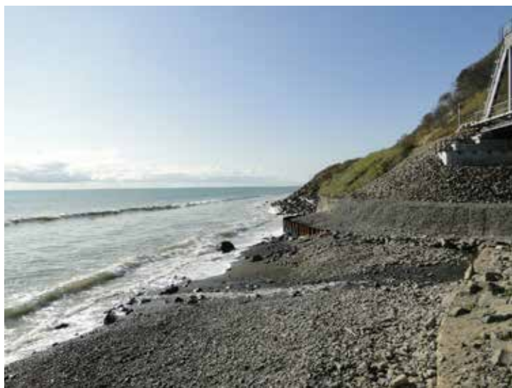
Рис. 1. Подмыв устоев моста на 263-м км участка Корсаков – Ноглики Дальневосточной железной дороги. 2020 год [фото авторов].
