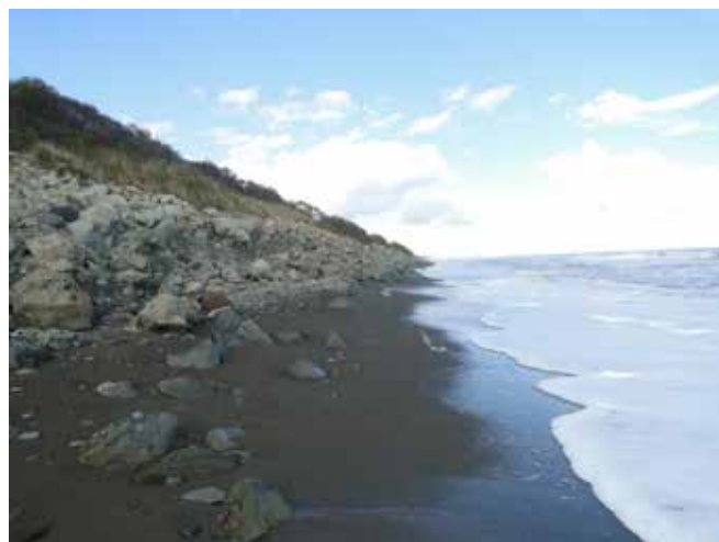
Рис. 3. Подмыв основания откоса земляного полотна на 273-м км участка Корсаков – Ноглики. 2020 год [фото авторов].
